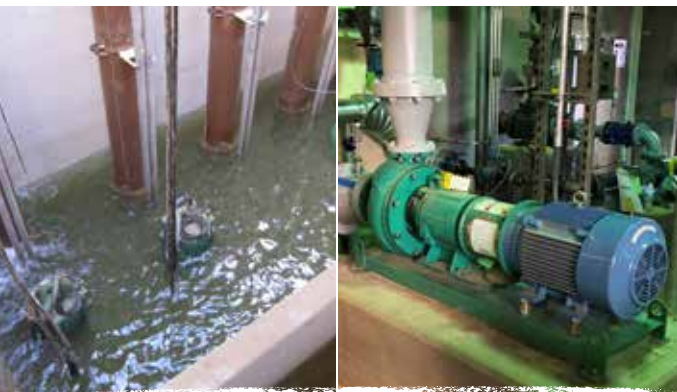
Filtrados de Estación de Redes de Alcantarillado
